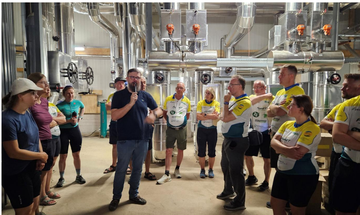
Abbildung 11: Andreas Rasche (Rasche & Weßler GmbH, mit Mikrofon) erklärt in der Wärmeverteilstation von Alfhausen die Beladung des Wärmespeichers und die Funktion des Wärmenetzes.
