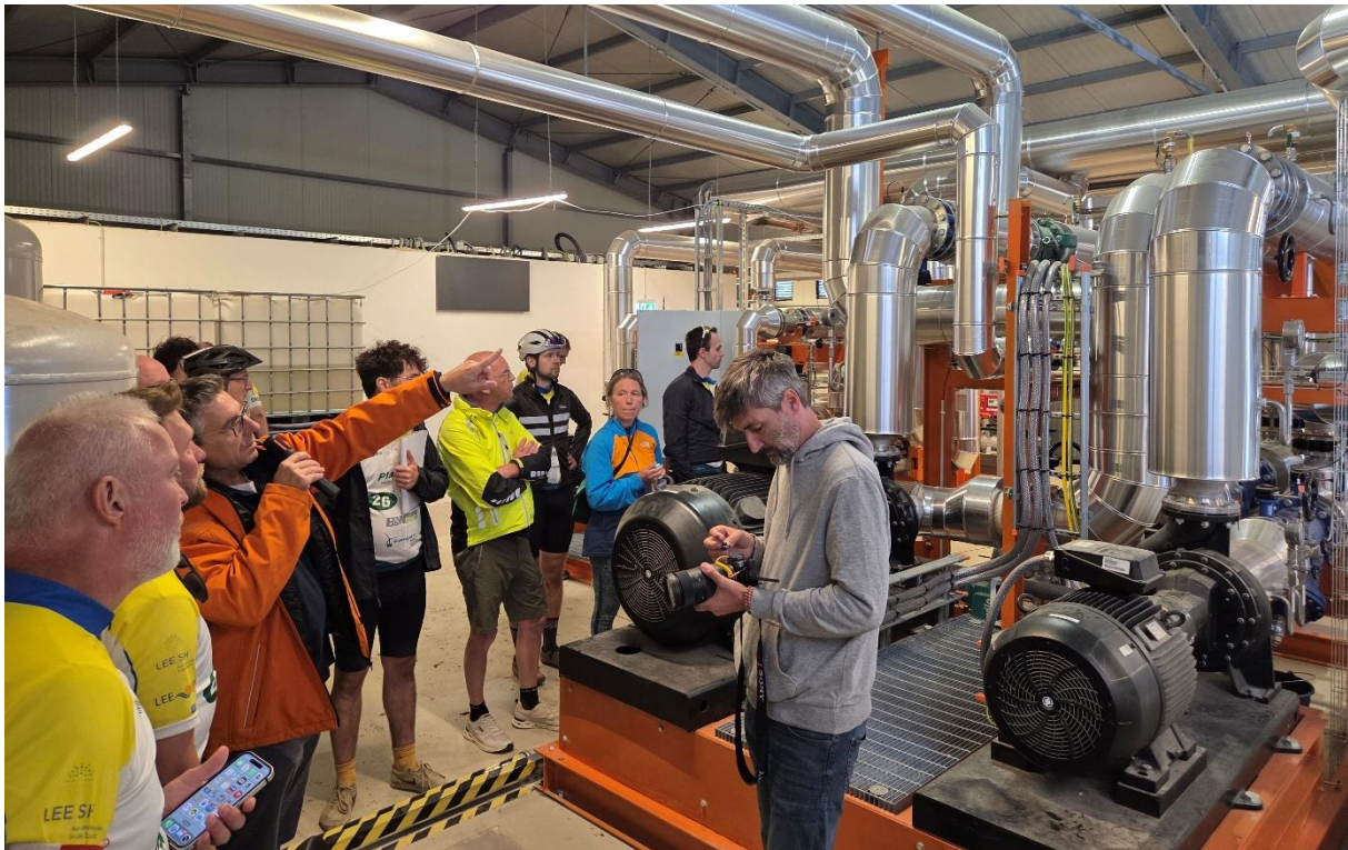
Abbildung 43: In der Wärmeverteilstation berichtet Björn Ruschepaul, Leiter Fernwärme bei den Stadtwerken Lübeck (links, mit oranger Jacke), wie der verbrauchsgerechte Transport der Solarwärme in das Wärmenetz des Stadtteils Moisling funktioniert.
